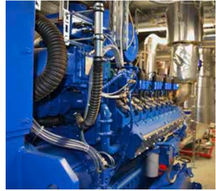
Im Erdgeschoss der Energiezentrale: das BHKW des Herstellers SES Energiesysteme GmbH
