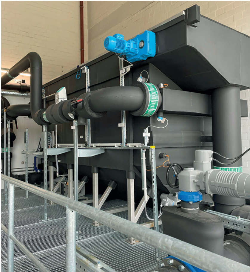
Bild 2. Der Flusswasserwärmeübertrager wurde aufgrund der Statik im Erdgeschoss des Kesselhauses auf einer Stahlträgerkonstruktion platziert. Ein zusätzlicher Ablaufbehälter befindet sich darunter im Keller
