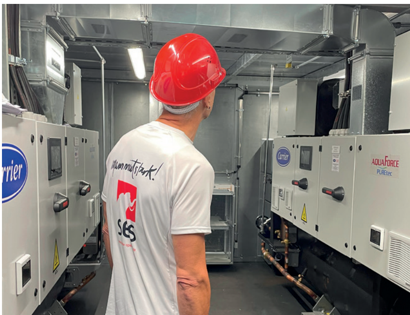
Bild 3. Die beiden Wärmepumpen sind in einem schallgedämmten Maschinenraum oberhalb der Kesselanlagen im Heizkraftwerk aufgestellt
